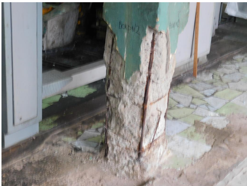
Коррозия рабочей арматуры, скалывание защитного слоя бетона несущей колонны корпуса.
