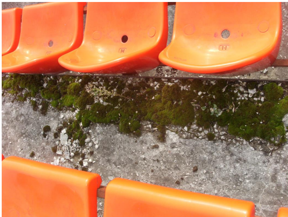
Биологическая коррозия бетона трибун ( рост мхов).
