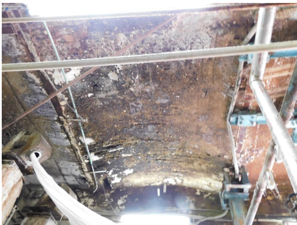
Карбонизация бетона монолитного перекрытия ( год постройки корпуса 1903г.).
