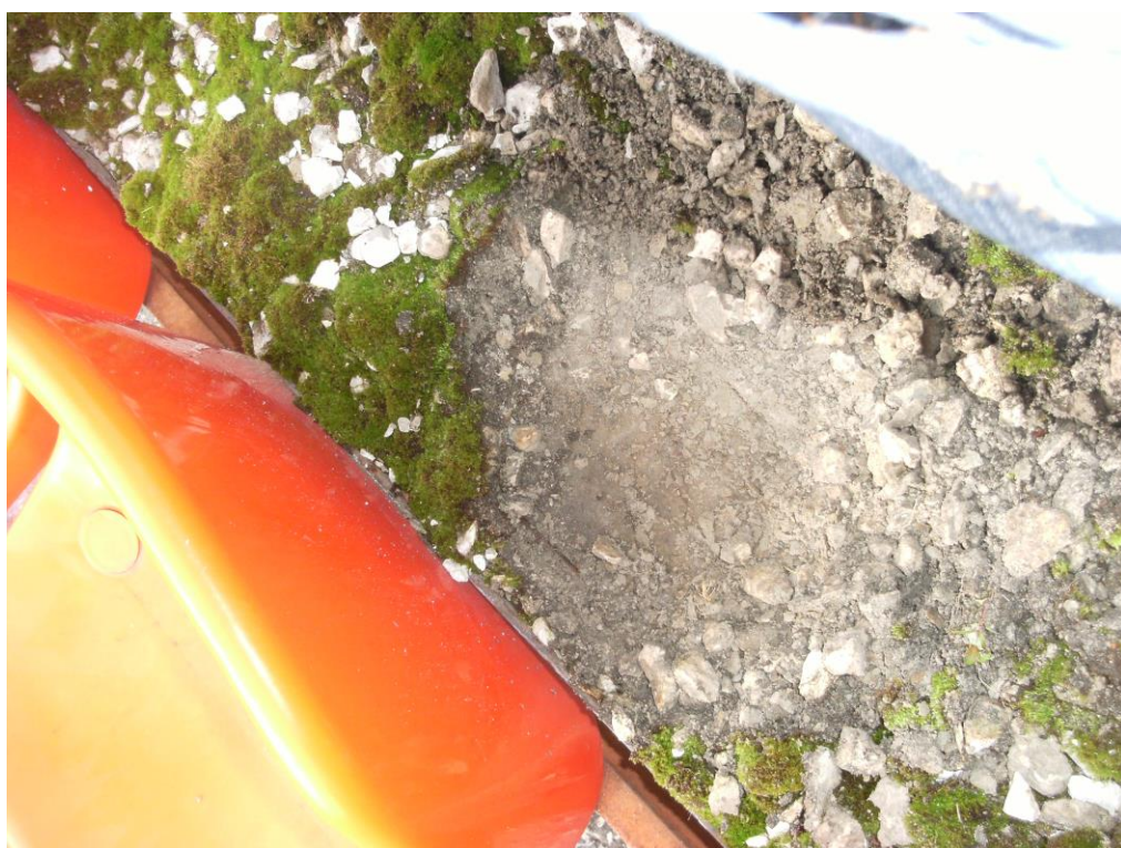
Разрушение бетона из-за биологической коррозии.
