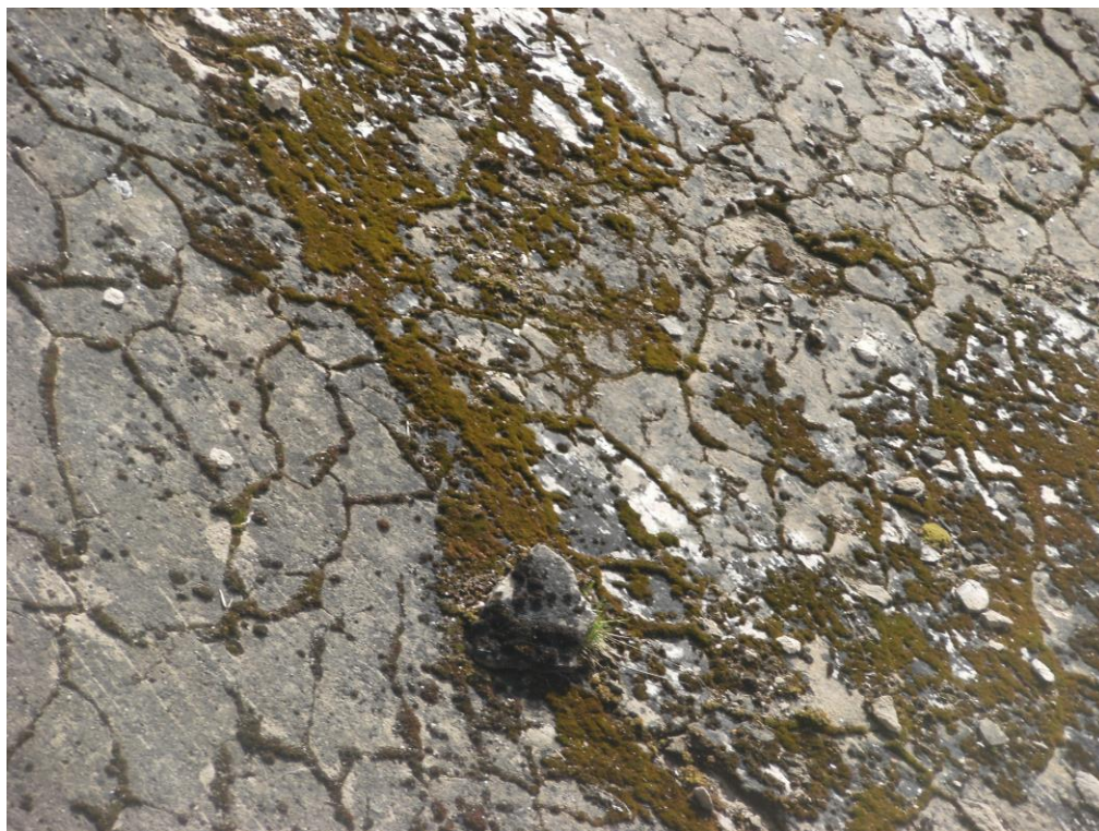
Разрушение бетонов из-за биологической коррозии (рост мхов и лишайников).
