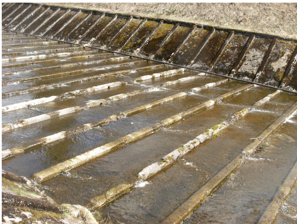
Карбонизация, вымывание, выветривания бетона, биологическая коррозия строительных конструкций быстротока плотины.
