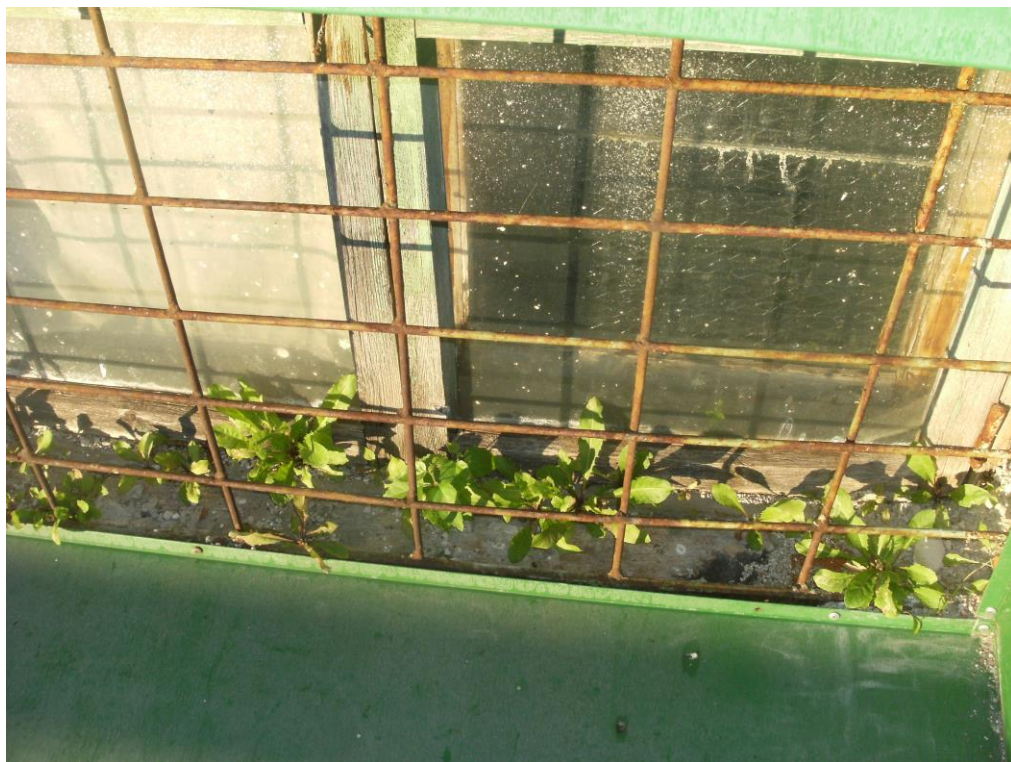
Рост растительности в теле бетона отлива окна.
