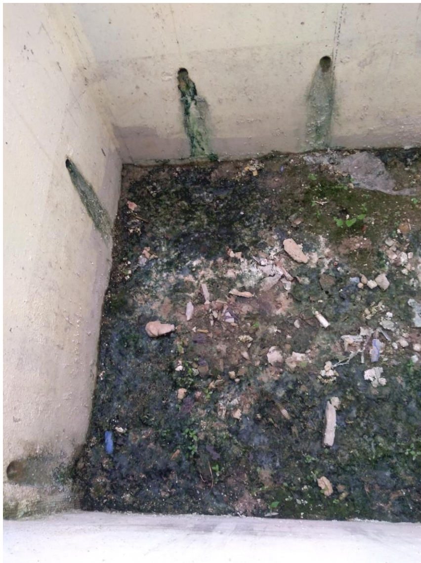
Проникновение вод в приямок цокольного этажа жилого дома.
