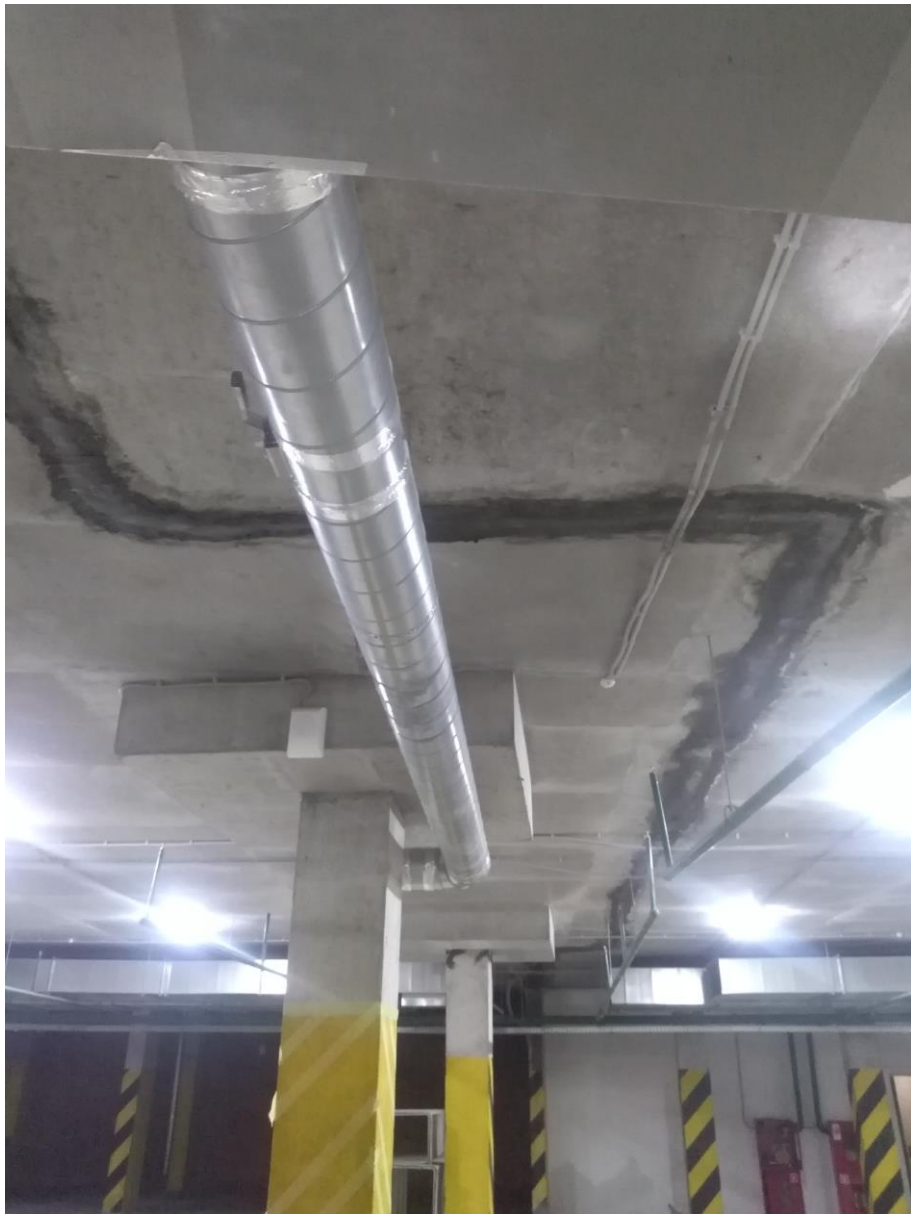
Проникновение вод через шов в зоне нулевых моментов ( расчески захваток бетонирования плиты) монолитного перекрытия подземного паркинга.
