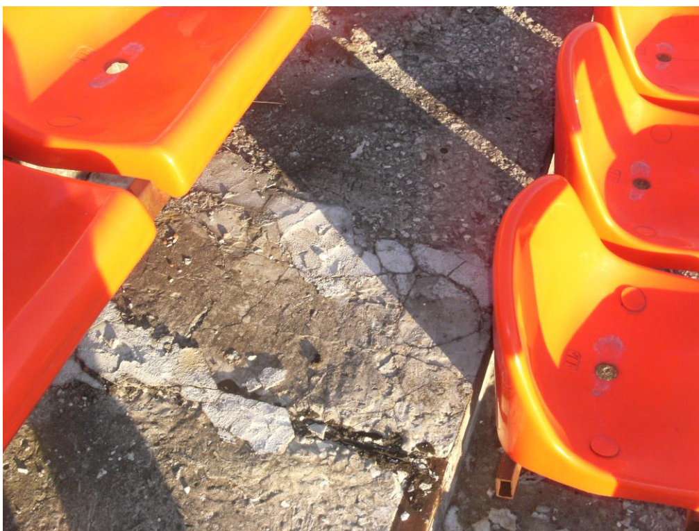
Характер разрушения шва сопряжения.
