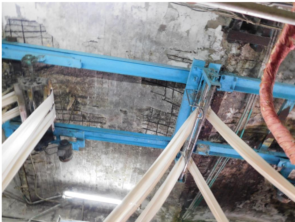
Скалывание защитного слоя бетона, коррозия несущей арматуры из-за карбонизации бетона за период эксплуатации.
