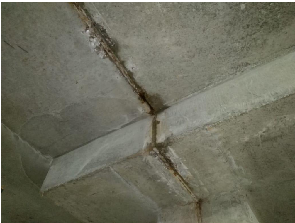
Неправильное устройство деф. шва.
